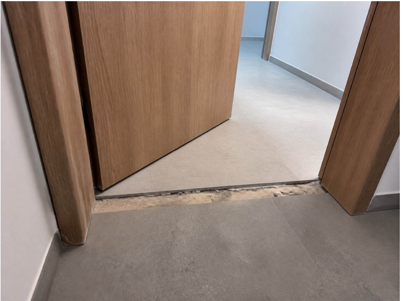
tuerschwelle.jpg angehängt an Türschwelle Wohnung B.2.04 schließen (3)
