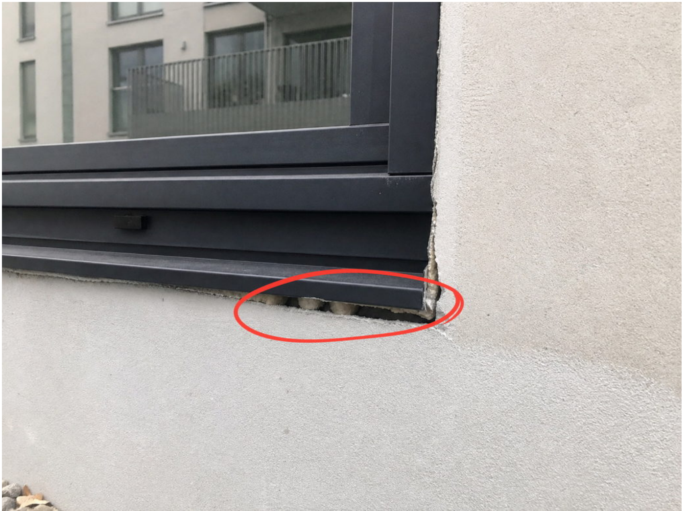
fensteranschluss.jpg angehängt an Fensteranschluss Wohnung B.3.02 abdichten (1)
